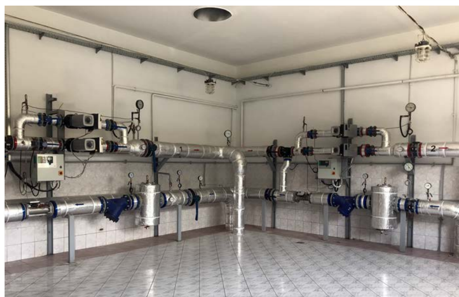
Na zdjęciach powyżej zmodernizowana kotłownia
