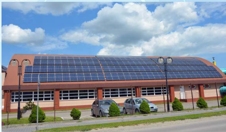
Instalacja OZE na budynku Miejskiej Pływalni „Wodnik”
